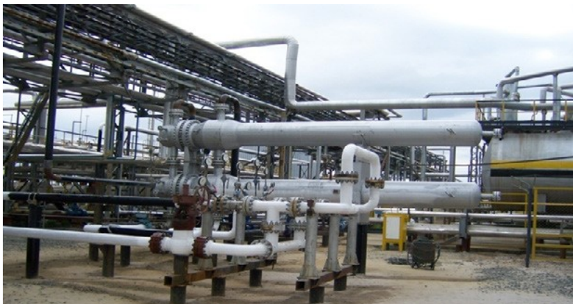
Фото 1 – Установка 3S-сепарации на УКПГ Губкинского месторождения ОАО «Роснефть»
