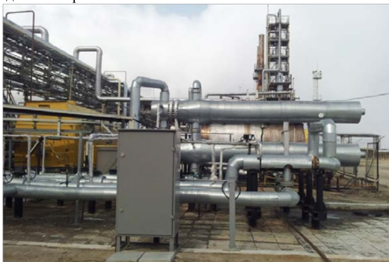
Фото 4 – Установка 3S-сепарации на Северо-Комсомольском месторождении ОАО «Роснефть»
