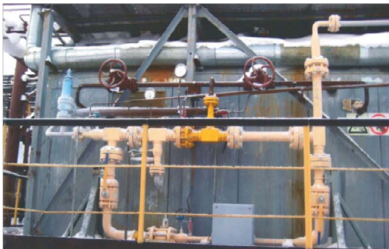
Фото 3 – Установка 3S-сепарации на Заполярные месторождения ОАО «Газпром»
